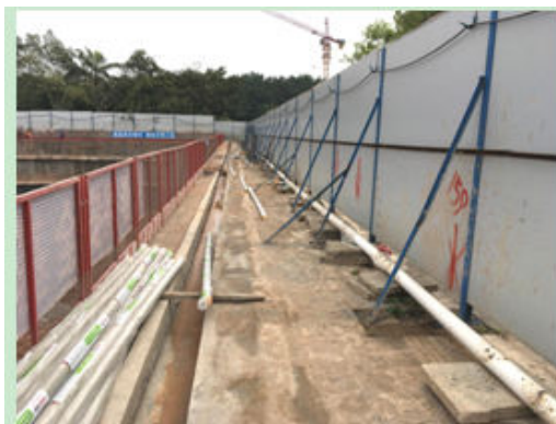
图 11 南地块基坑周边防护现状 1
