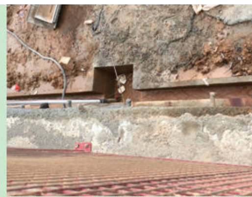
图 44 北地块坑底排水尘沙设施 2
