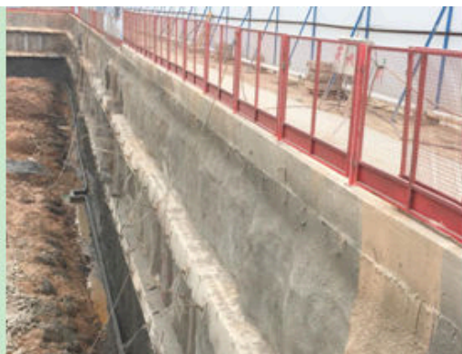
图 22 南地块坑底排水沉沙设施 3
