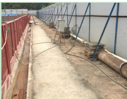
图 14 南地块基坑周边防护现状 4
