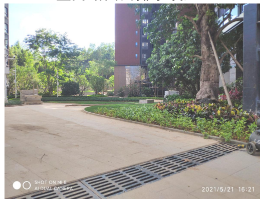
区内路面雨排水设施 10
