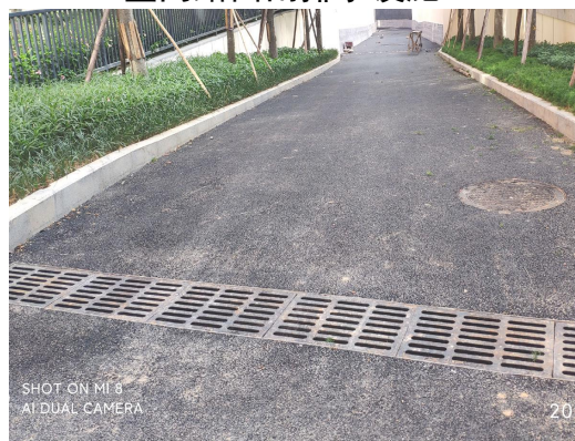
区内路面雨排水设施 6
