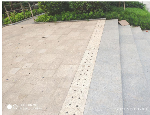
区内路面雨排水设施 2
