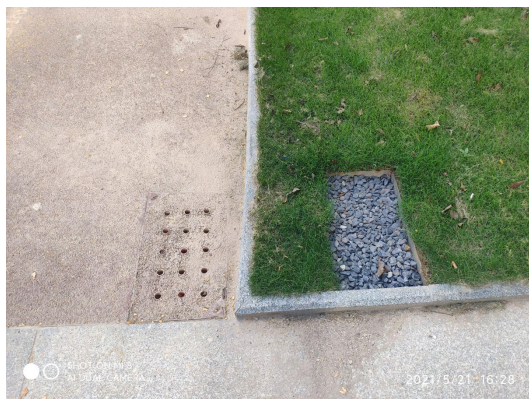
区内路面雨排水设施 3
