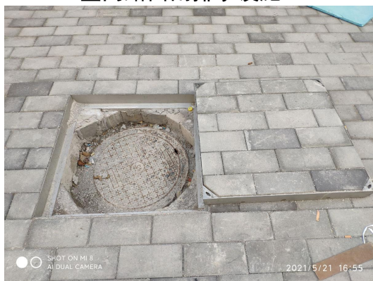
区内路面雨排水设施 7
