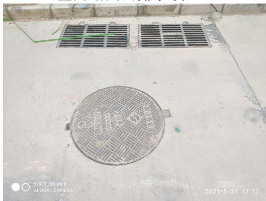
区内路面雨排水设施 9
