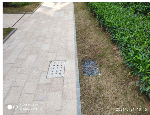
区内路面雨排水设施 4
