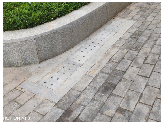
区内路面雨排水设施 1
