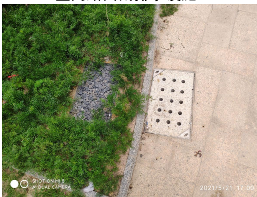
区内路面雨排水设施 8
