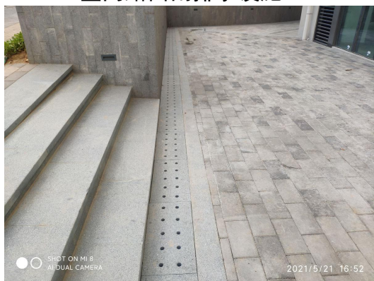
区内路面雨排水设施 5
